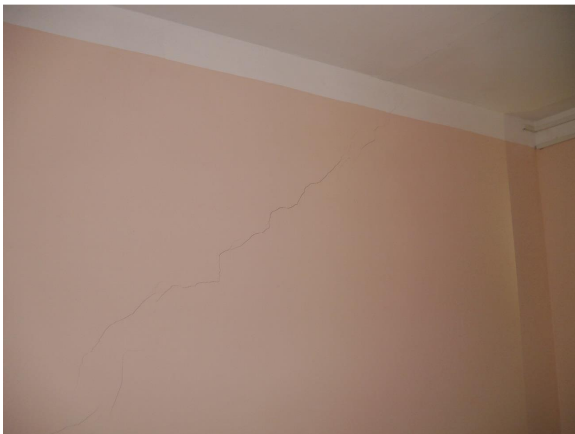
Фото 27 – Наклонная ступенчатая трещина в наружной несущей стене по оси «П», в уровне 11-го этажа.
