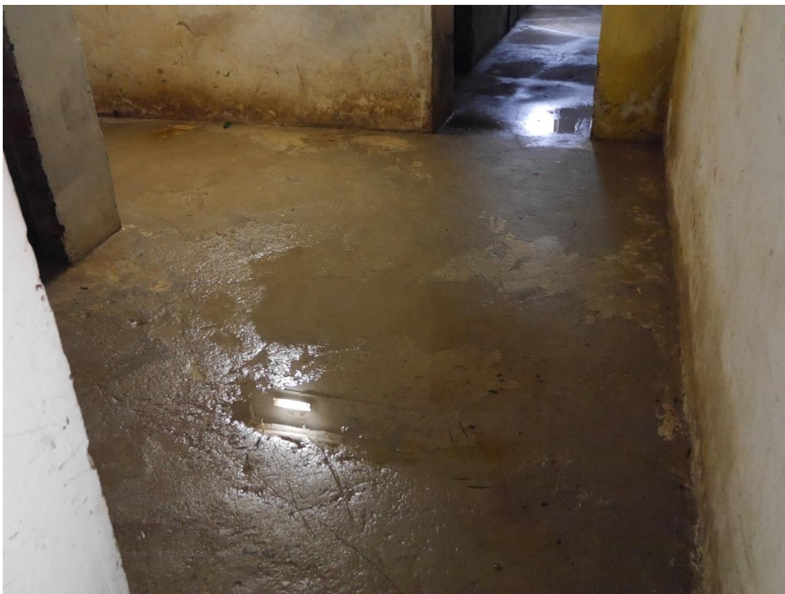
Фото 9 – Скопление воды в подвальном помещении поз. 97.
