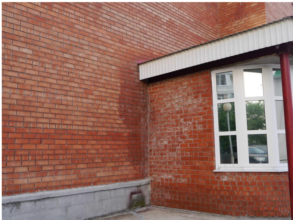
Фото 7 – Замачивание наружной кирпичной стены дома, а также примыкающей к ней стены пристроенного входа, в осях Г-Ж/20-21.
