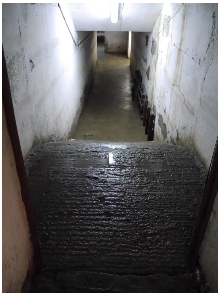
Фото 12 – Скопление воды по переходу в осях 1-2/1.
