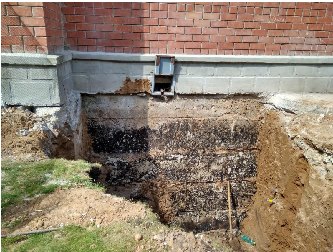
Фото 15 – Шурф №2. Отсутствие вертикальной гидроизоляции стен подвала.
