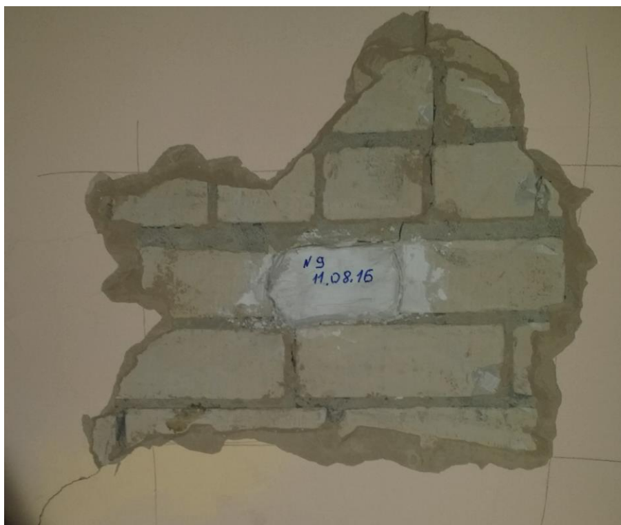
Фото 18 – Нарушения в устройстве кладки внутренней несущей стены по оси «П».
