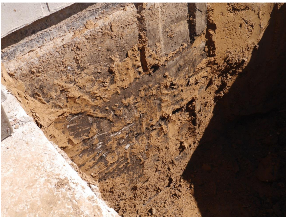
Фото 14 – Шурф №1. Отсутствие вертикальной гидроизоляции стен подвала.
