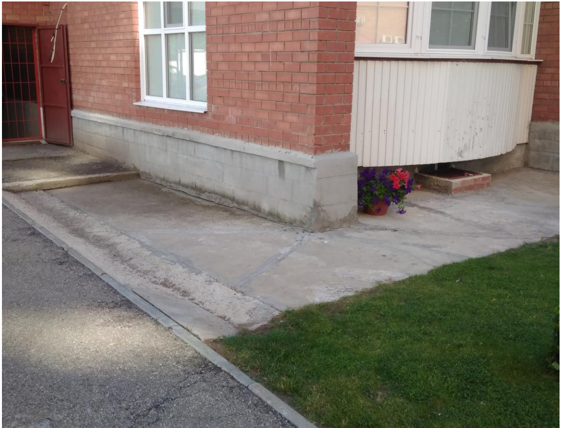
Фото 5 – Трещина между цокольной частью здания и отмосткой, трещины по отмостке.
