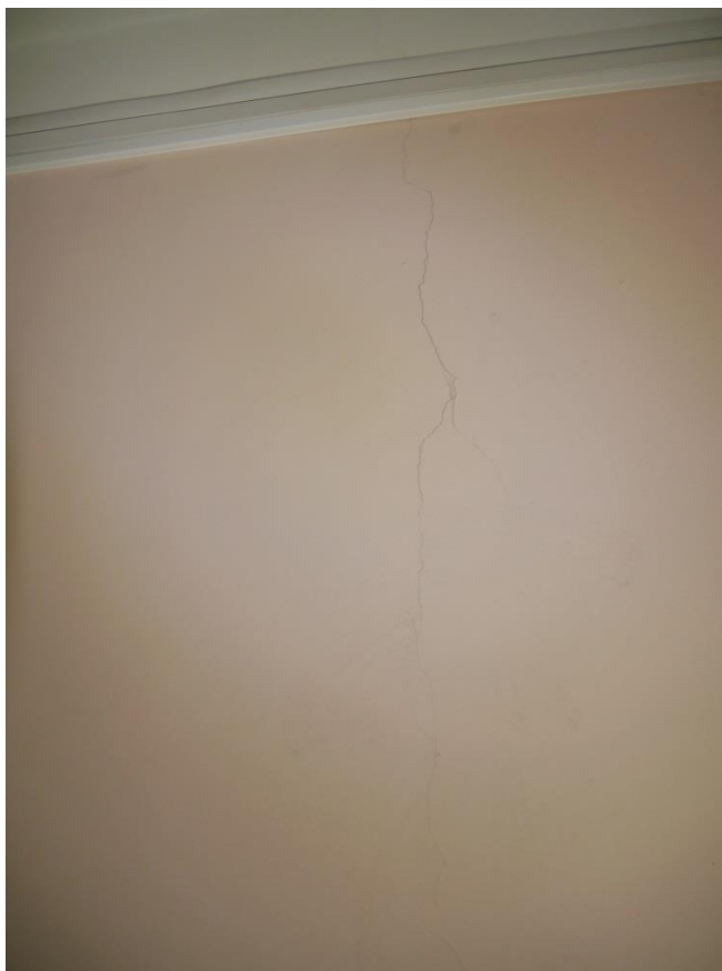
Фото 19 – Вертикальная волосяная трещина во внутренней несущей стене по оси «П», в уровне 6-го этажа.
