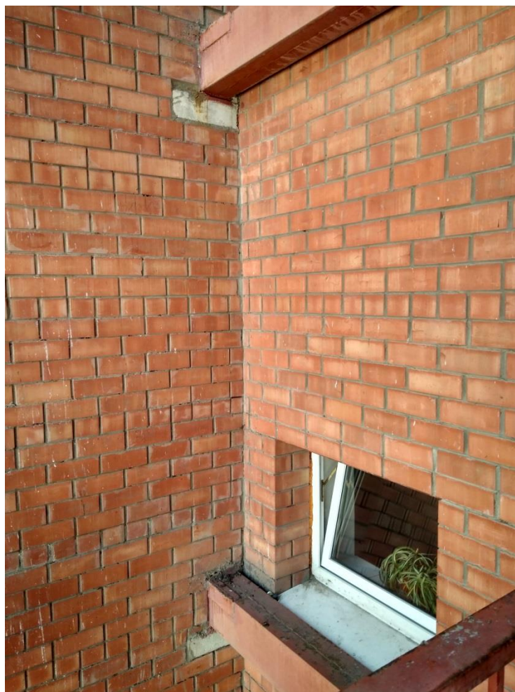
Фото 30 – Металлические косоуры наружной пожарной лестницы, заведенные в поперечную стену по оси «11», примыкающую к несущей стене по оси «П»
