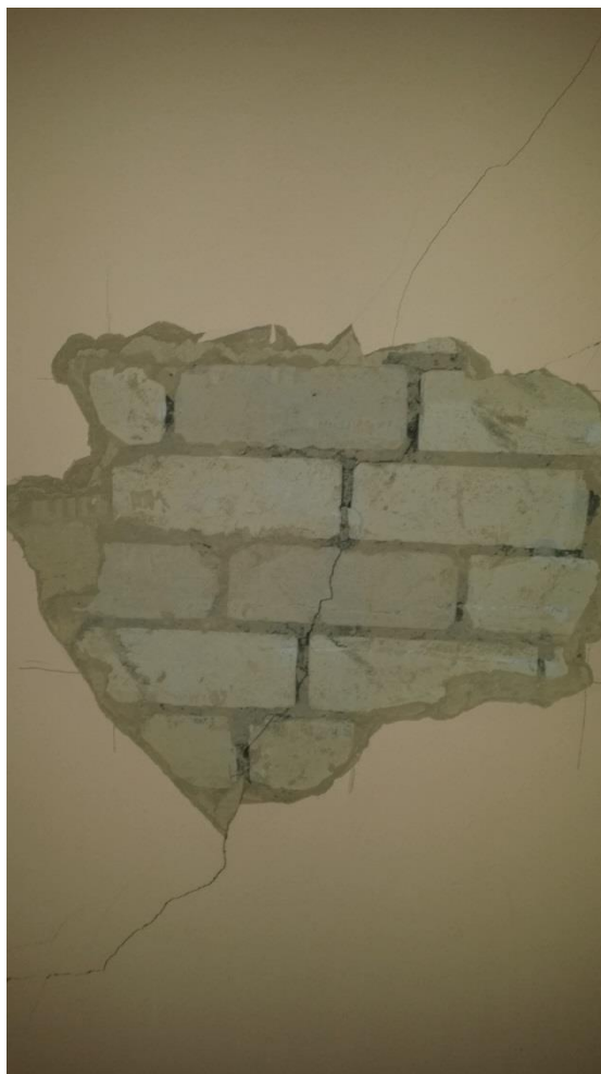
Фото 17 – Наклонная силовая трещина во внутренней несущей стене по оси «П».
