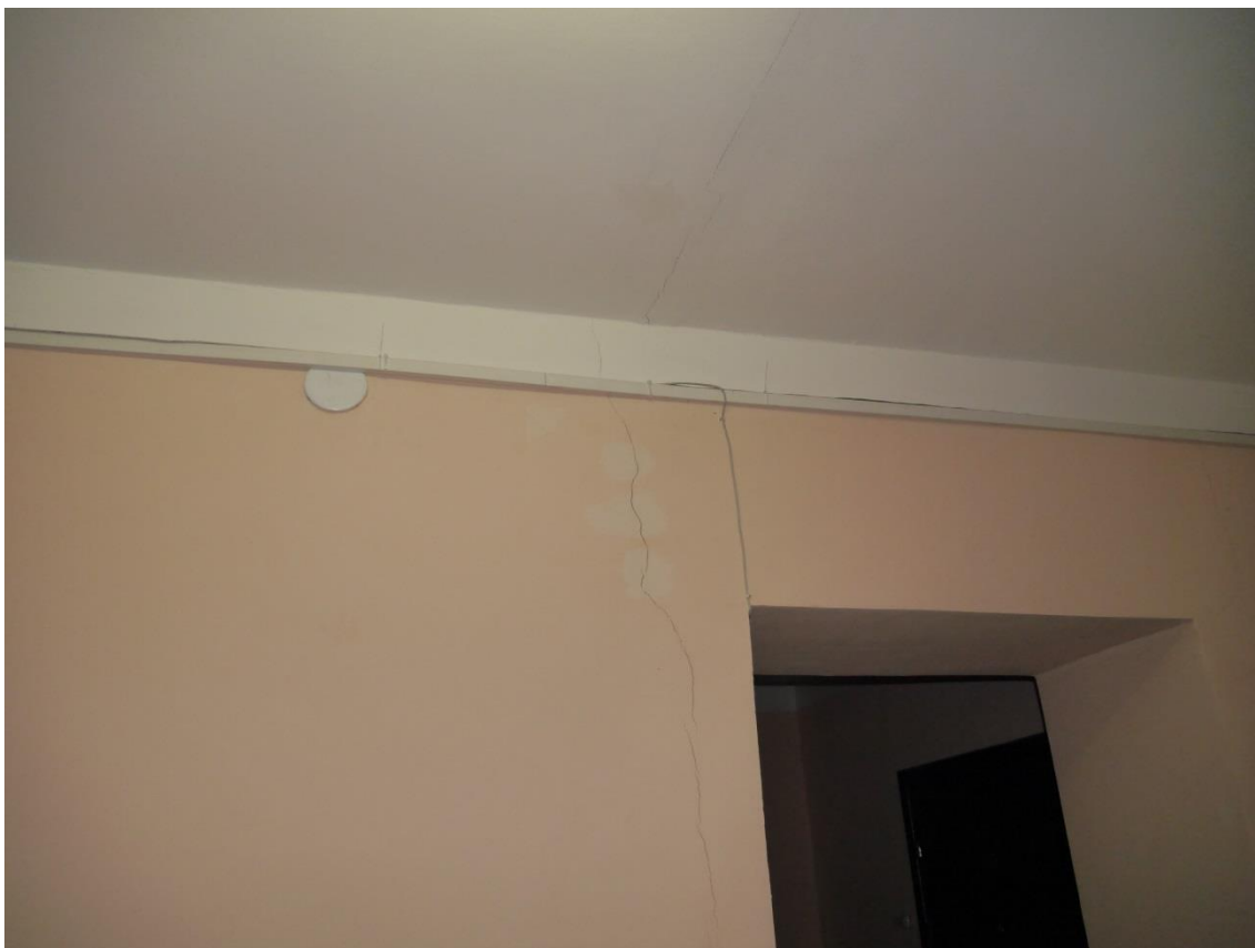
Фото 25 – Трещина вблизи дверного проема в осях 14-15/П, в уровне 10-го этажа.
