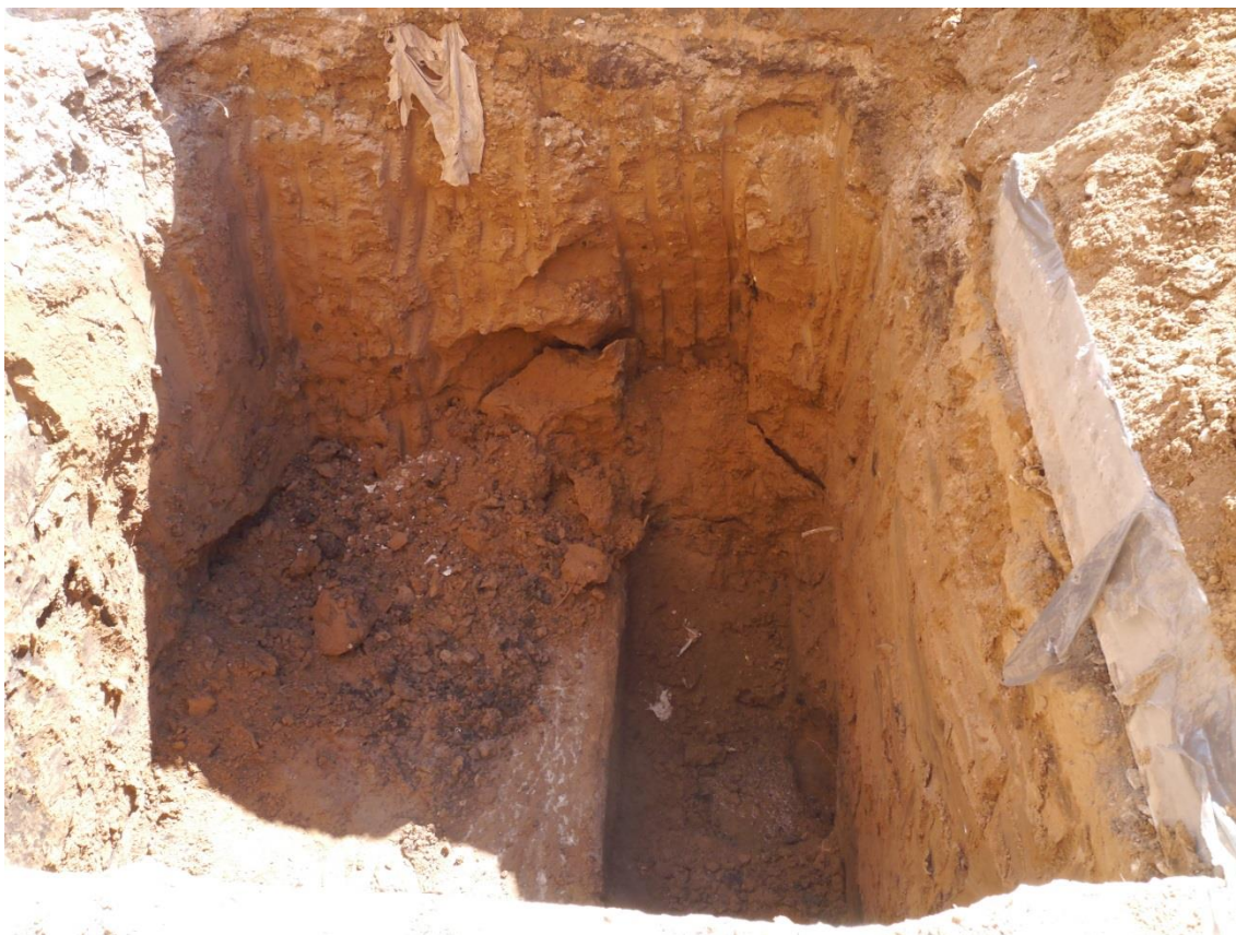
Фото 13 – Шурф №1 с увлажненным грунтом в основании.
