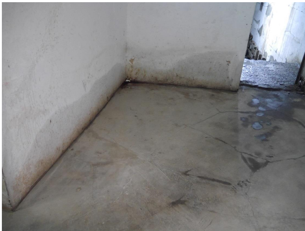
Фото 11 – Следы увлажнения по полу и стенам подвального помещения поз. 1.
