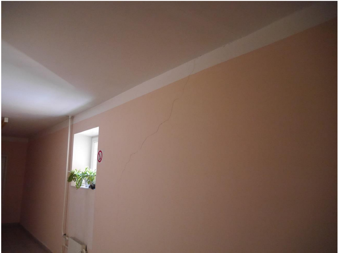
Фото 23 – Наклонная ступенчатая трещина в наружной несущей стене по оси «П», в уровне 10-го этажа, переходящая через шов в уровне опирания плит в трещину по русту.
